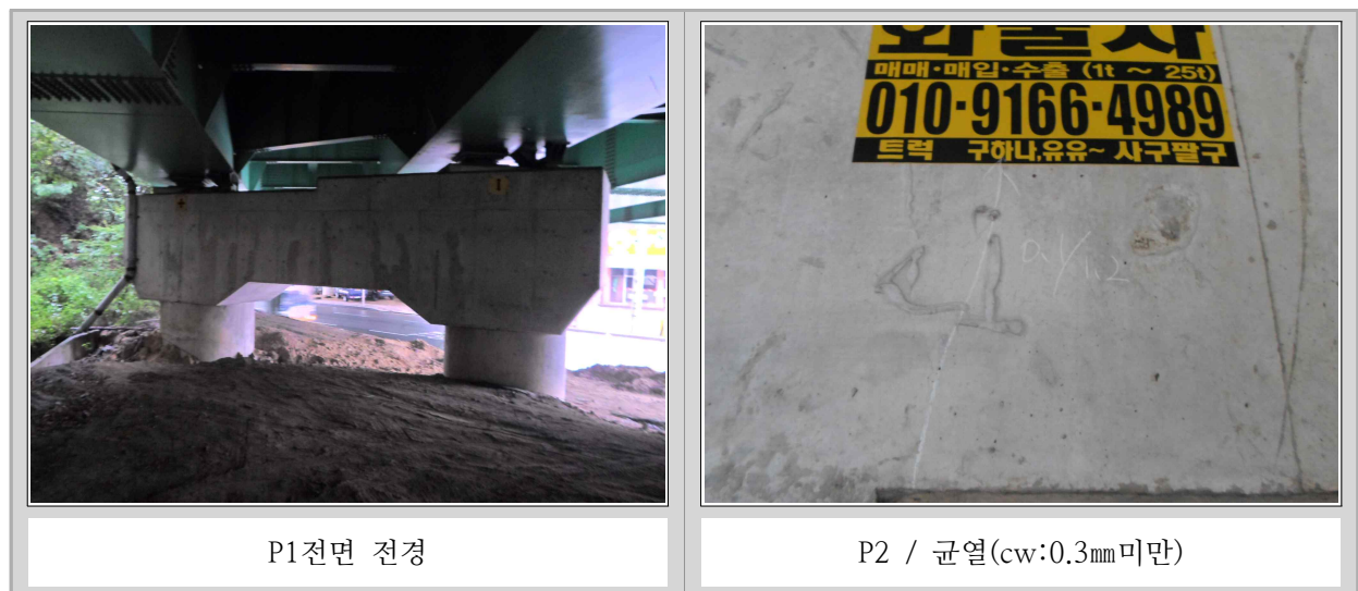
〈그림 2.1.6〉 교대 현황 및 손상사진
