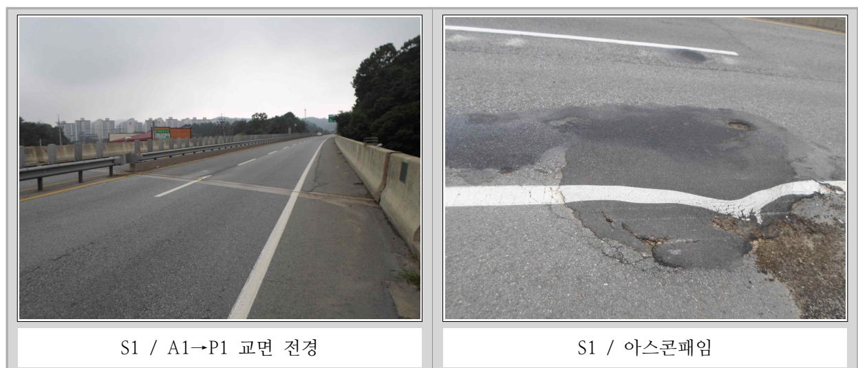
〈그림 2.1.13〉 교면포장 현황 및 손상사진
