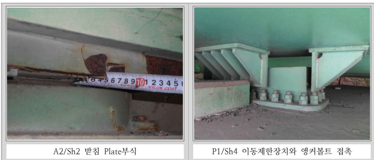
<그림 2.1.8> 받침장치 현황 및 손상사진
