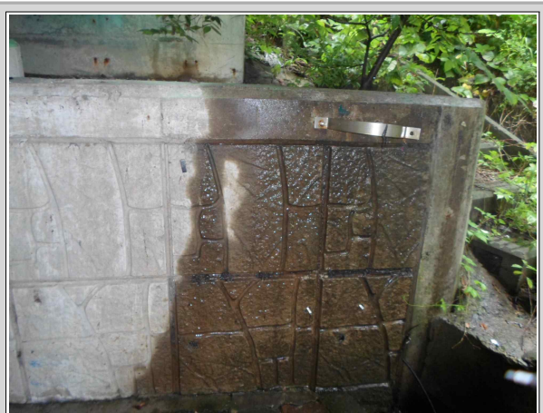
A2 / 누수흔적(배수관 길이부족)
